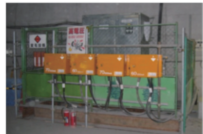
電気設備の例
