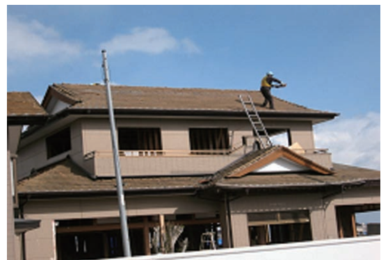
写真－３ 墜落防止対策のない法違反作業
