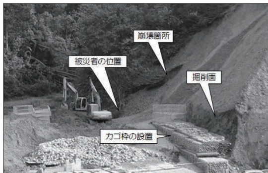
図-2 工事中に発生した土砂崩壊の生き埋め災害
