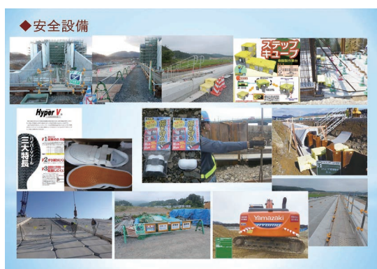
写真－7 安全設備
