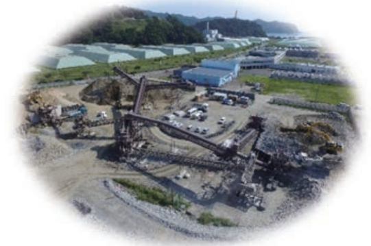
写真－２ 盛土材製造プラント
