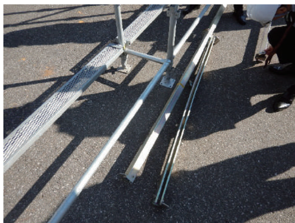
スライドレールの変形状態
