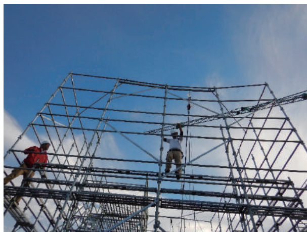
一側足場部の変形状態
