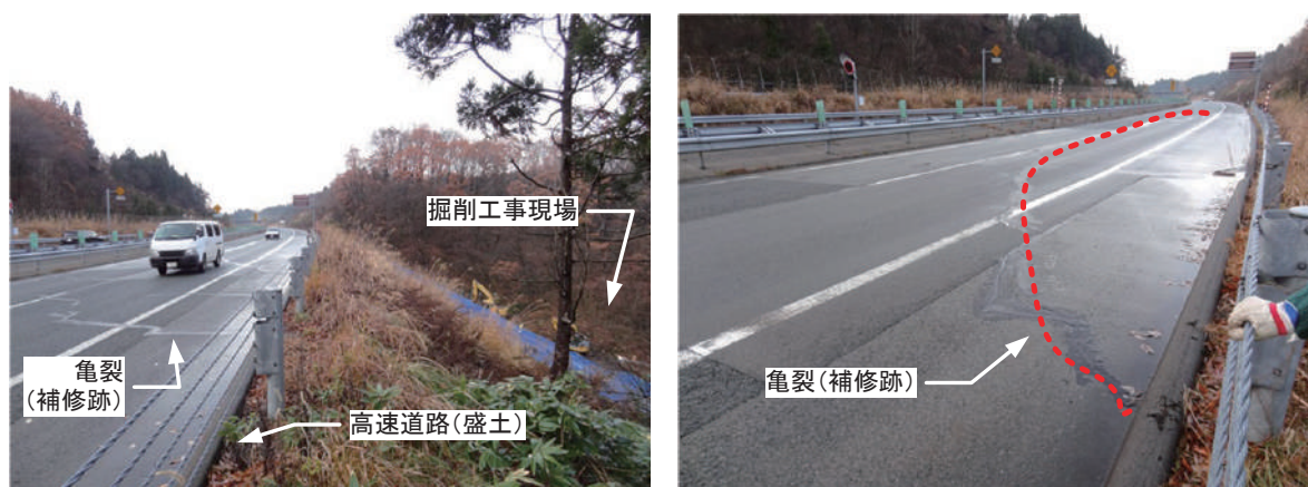
図Ⅱ-2-10 道路盛土に生じた変状とその下方における補強工事
