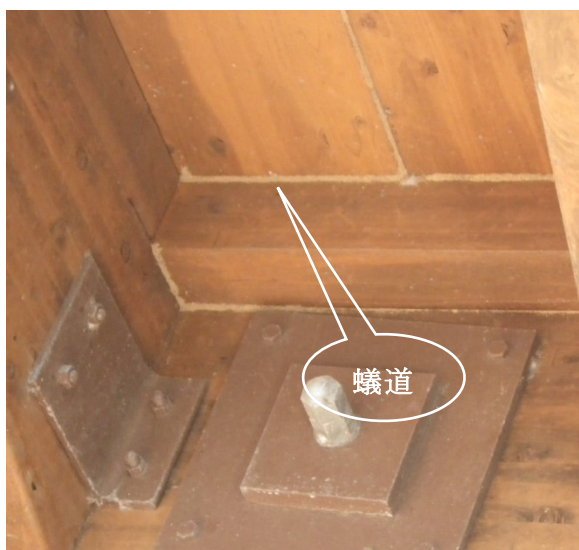
写真 2.2.5 しろありの蟻道の事例
