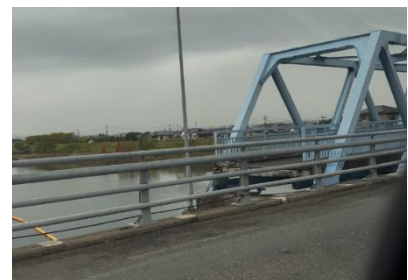
歩道部分の橋桁が脱落した植柳橋
